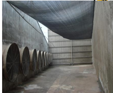
風扇後設置擋板及防塵網
